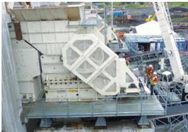
La tramoggia del frantoio primario dell'impianto sul Pacifico
